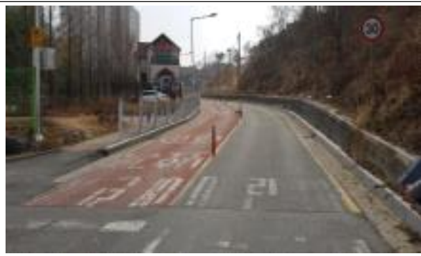
③ 두마초교 - 규제봉 파손 및 노면표시 노후
